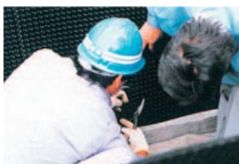
配管部等は簡単に穴が開きます。
